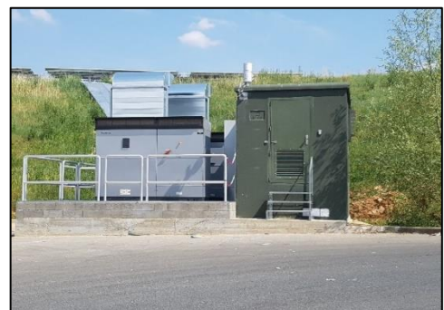
Figure 12 : Poste de transformation (Crédit photo : SERGIES, 2017)
