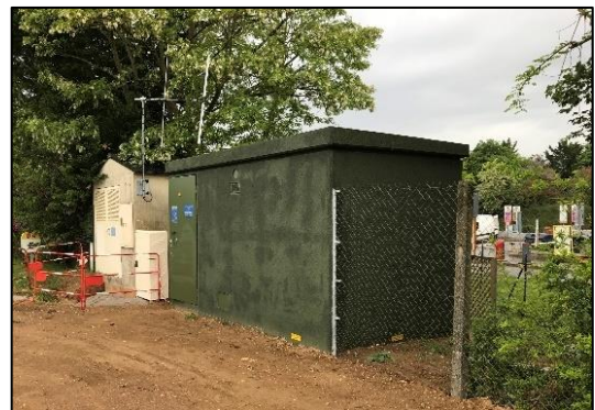
Figure 13 : Poste de livraison (Crédit photo : SERGIES, 2015)
